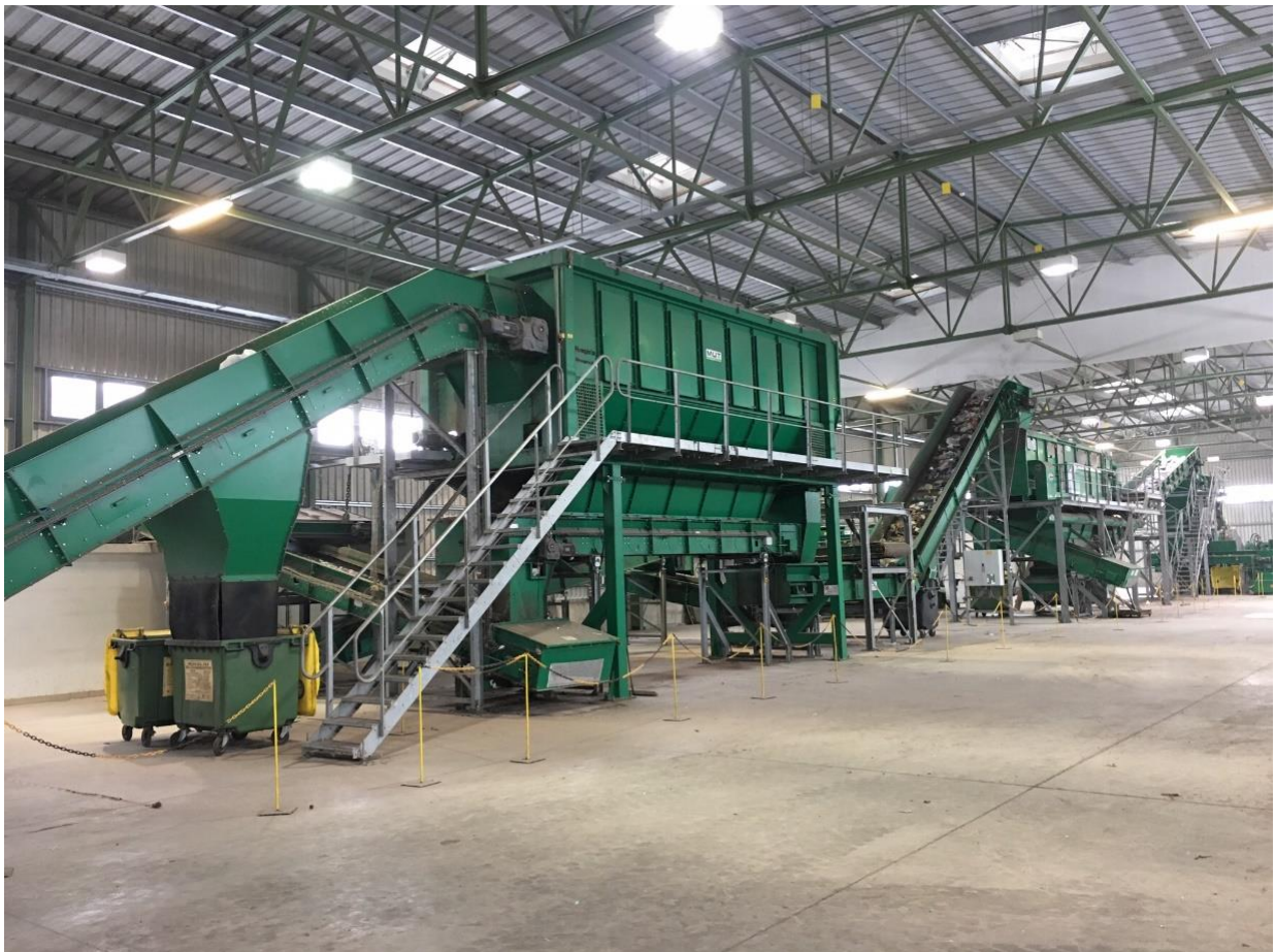
Obr. č.28 Linka na mechanicko – biologickú úpravu odpadu v Maďarsku, mechanická úprava – oddeľovanie ľahkej a ťažkej frakcie, Zöld Völgy Nonprofit Kft, Sájokaza
